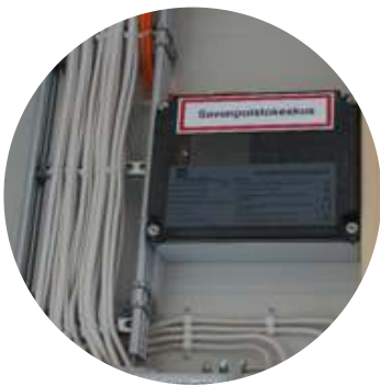
Savunpoistokeskus ja kaapelointi.
